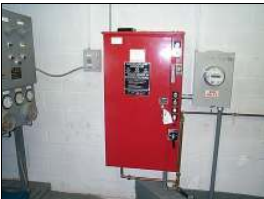
23. Fire sprinkler controller
